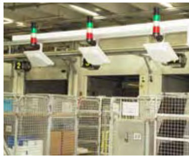
Am Hallenübergang sind quer zur Fahrtrichtung zwei Antennenreihen an der Hallendecke befestigt.
